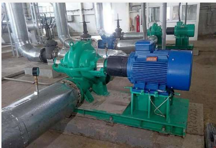
Насосные станции для ТОО «Алматинские тепловые сети»
