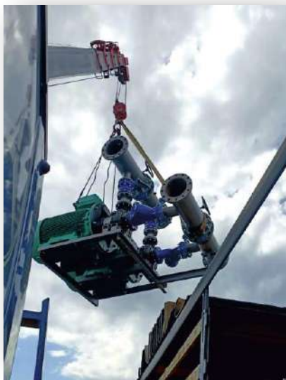
Насосная станция Узбекистан, г. Ташкент
