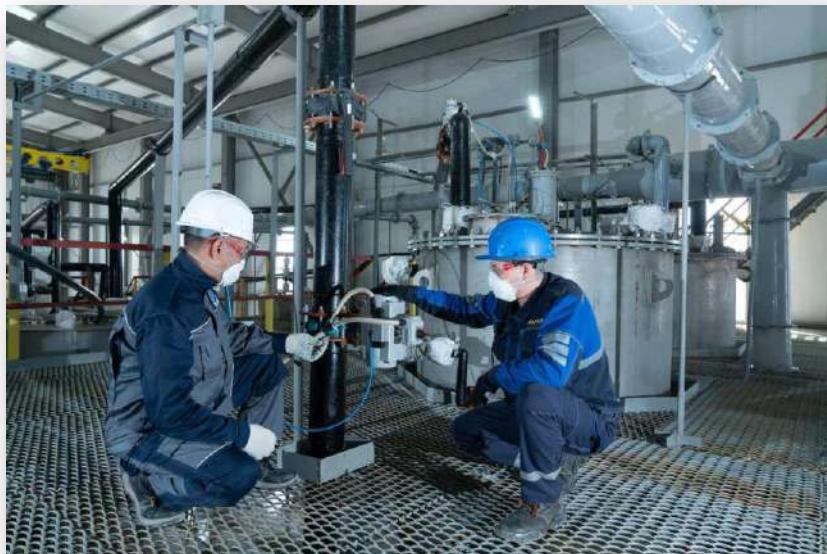
Оборудование для АО «НАК «Казатомпром»
