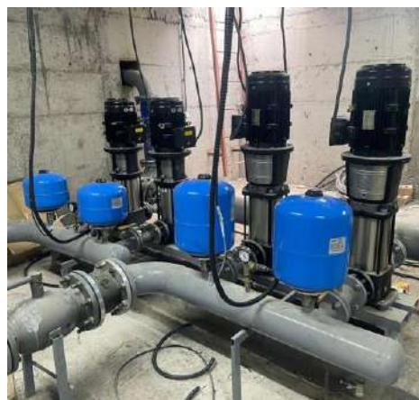
Насосная станция Кыргызстан, г. Бишкек ЖК Флоренция
