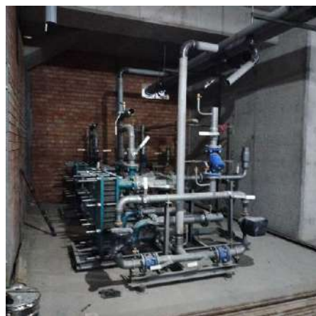
Насосная станция Узбекистан, г. Ташкент ЖК U-Tower
