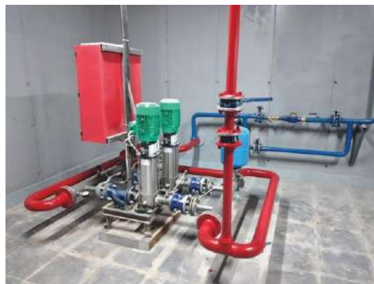
Насосная станция Узбекистан, г. Ташкент ЖК Mirzo Ulugbek
